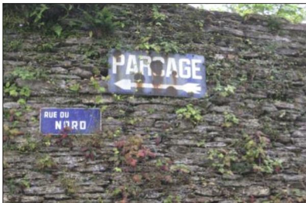
État du vieux mur avant restauration
